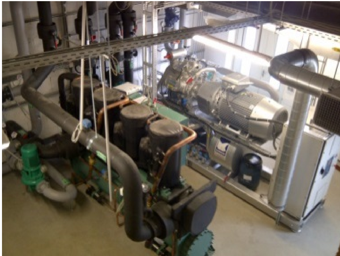
Ansicht neue Energiezentrale mit BHKW
